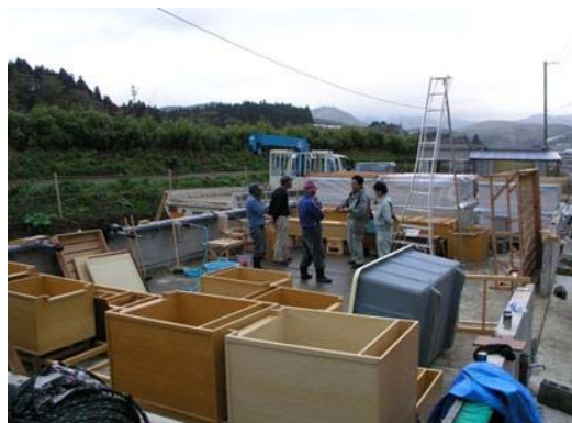
図3 被災ふ化場での現地実態調査 ふ化室を応急復旧して卵の収容をしていた宮城県本吉町の小泉ふ化場
