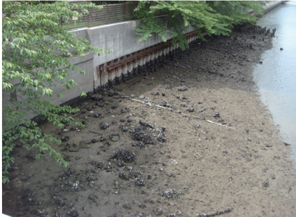
写真1 運河内の砂溜まり
