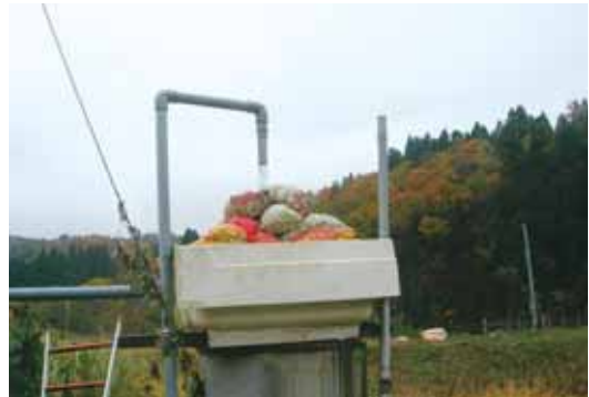
写真2 変更前の曝気(ばっき)装置
