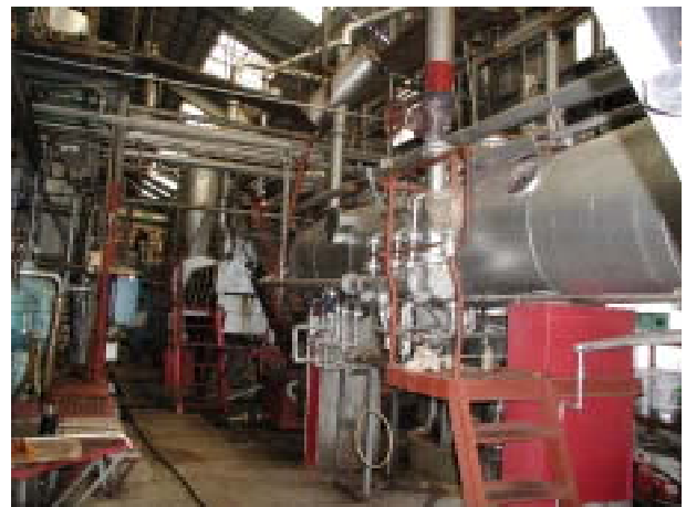
写真2：フィッシュミール工場の内部：
