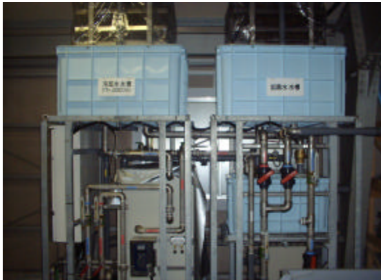
写真5．徳志別事業所のふ化室に設置した水温調整装置（タカツ電機商会製 TR-J300DCHA．加温・冷却型）．
