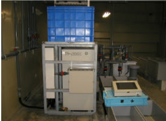
写真1．静内事業所のふ化室に設置した水温調整装置（タカツ電機商会製 TR-J300DC．冷却型）．
