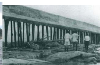
海底地盤中にある木材 （護岸木杭）
