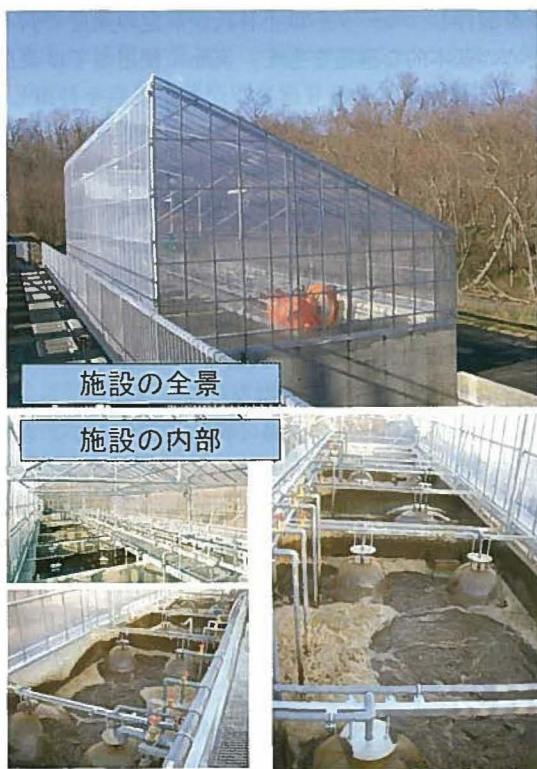
手前から奥に向かって貯留槽、調整槽1～2、沈殿槽
