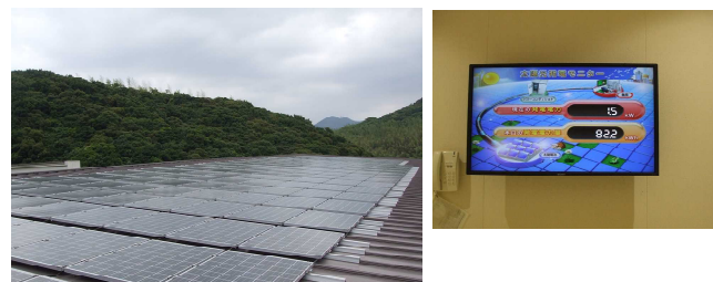
水産大学校多目的学生教育棟に設置された太陽光発電パネル（左）及び発電状況を表示するパネル（右）
