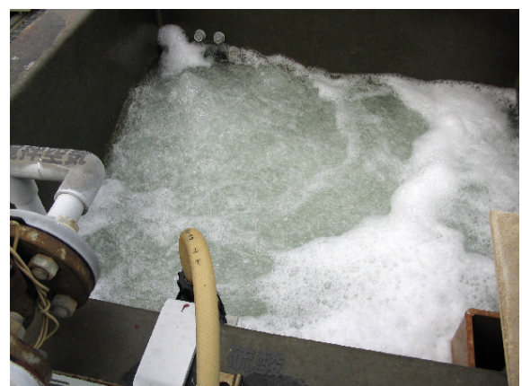
排水処理設備（瀬戸内海区水産研究所）
