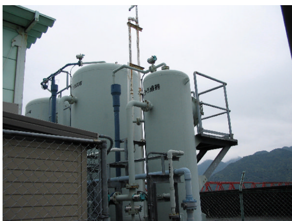
排水処理施設（瀬戸内海区水産研究所）
