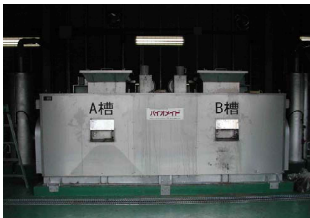
資源再生処理設備；バイオメイト (処理量：300kg／48時間)
