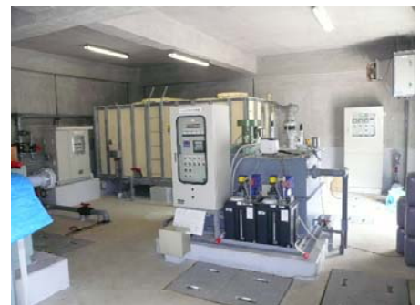
排水処理設備（西海区水産研究所）
